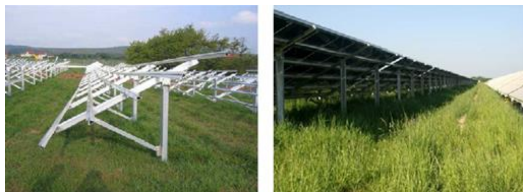
Photo 1 : Exemple de structures portantes, reposant sur profilés acier sans fondation béton (TOTALENERGIES)
