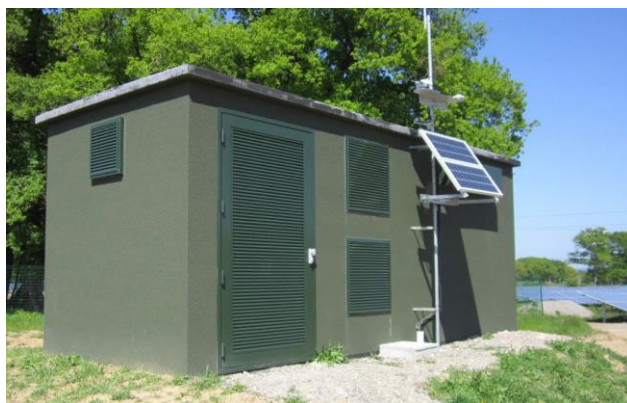
Photo 4 : Exemple de poste de livraison (TOTALENERGIES)
