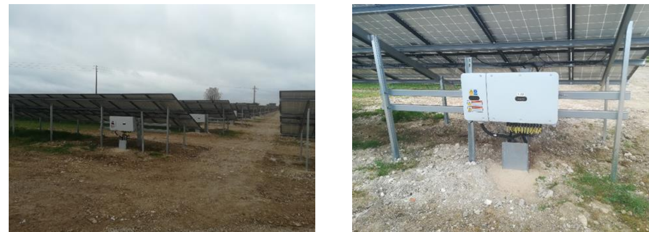
Photo 3 : Vue sur un onduleur et câble enfoui dans le sol (TOTALENERGIES)
